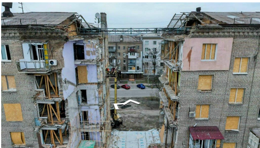
Рисунок 2.3 – Зруйнований житловий будинок м. Запоріжжя пр. Соборний 151
